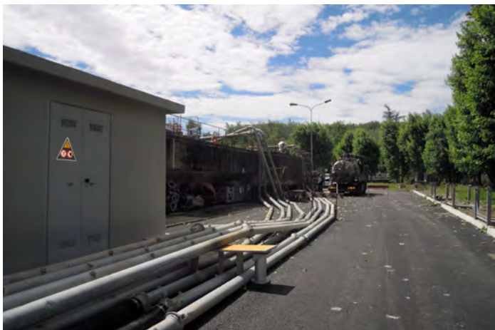
Il bypass ha funzionato per 29 giorni senza nessuna interruzione
